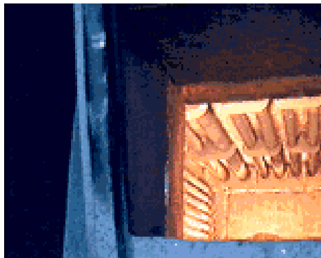
Figura 12 – Aspecto térmico da câmara de radiação de um forno de uma unidade de destilação de petróleo
